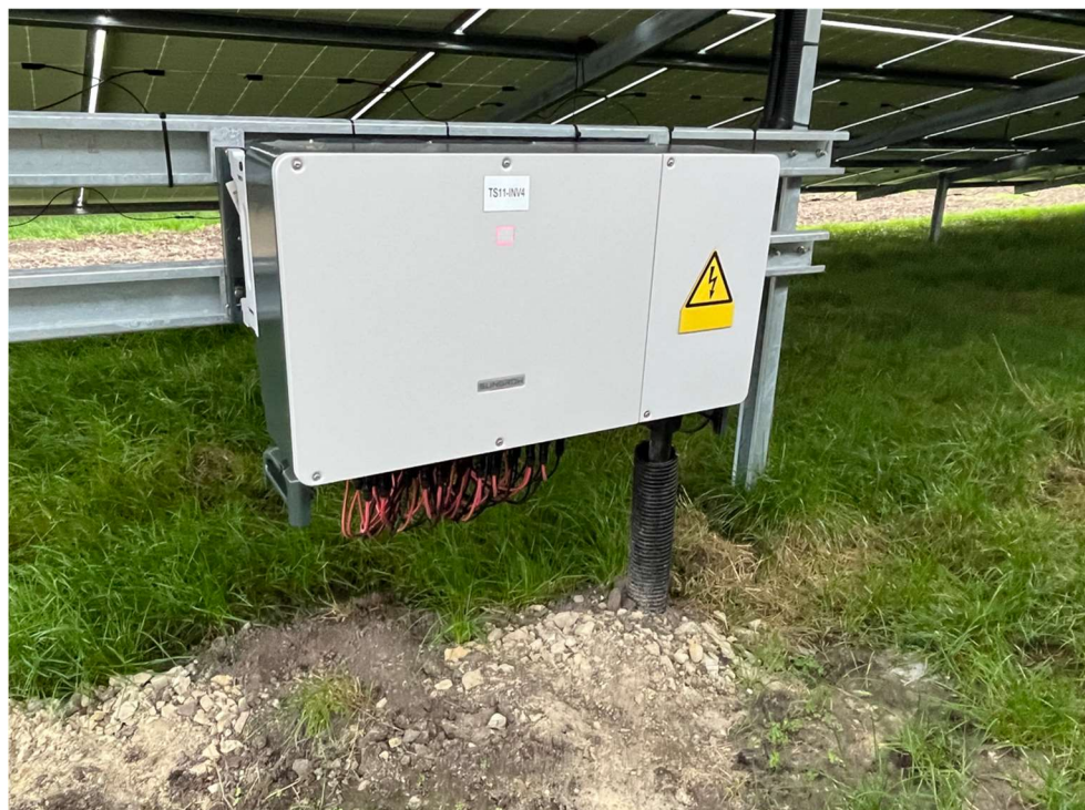
Figur 5. 100 kW inverter, som omdanner jævnstrøm til vekselstrøm, som ledes i jordkabel til step up transformer
