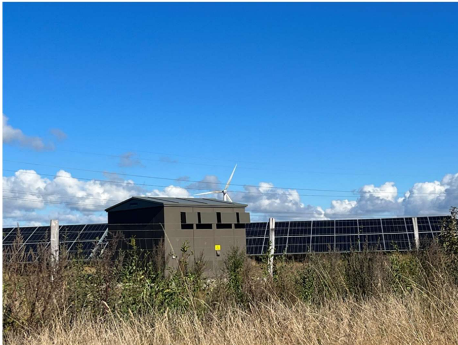
Figur 6. Step up transformere, som sender strømmen videre til N1 ved Højbjergvej.
